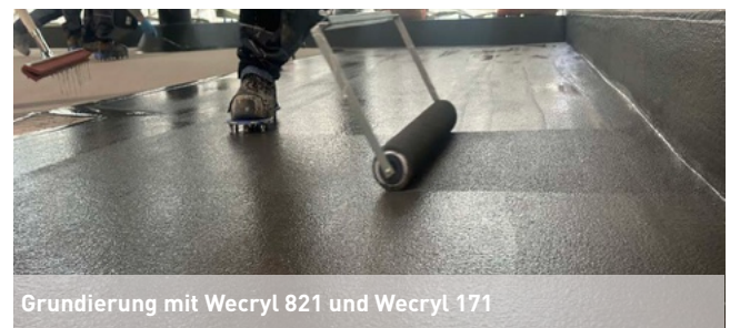
Beschädigter Untergrund vor der Sanierung
