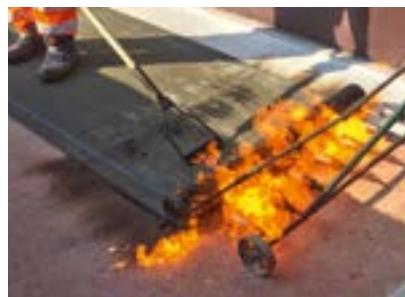
Die Wartezeit bis zum Verlegen der Bitumen-Schweißbahn beträgt nur ca. zwei Stunden. Das gilt sogar für Wintermonate, da PMMA auch bei -5°C verarbeitbar ist.
