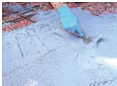
Nach 20 Minuten war die Grundierung ausreagiert. Zum Egalisieren wurde der neue Wecryl Betoninstandsetzungsmörtel eingesetzt.
