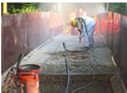
Ein Teilbereich der Betonoberfläche war so weit geschädigt, dass die Bewehrung frei gelegt wurde.
