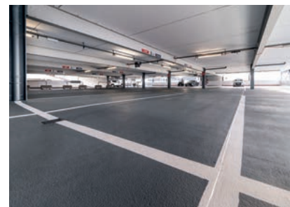
Auch sämtliche Stellplatzmarkierungen wurden mit Wecryl 288 von WestWood realisiert.
