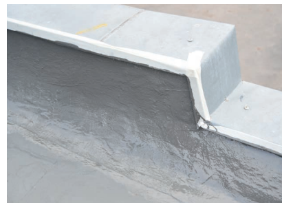
Aufkantungungen wie Attiken können aufgrund der flüssigen Verarbeitung nahtlos sicher abgedichtet werden.
