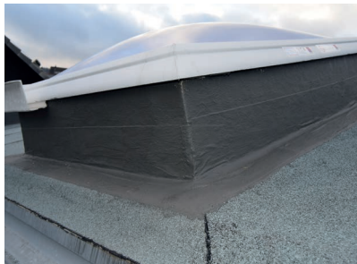
Nach der Vorbereitung und Reinigung des Untergrundes wurden die Dachkuppeln mit dem Wecryl R 230 thix abgedichtet.
