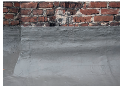
Der Anschluss der Bitumenbahn an das vorhandene Mauerwerk wurde dauerhaft sicher abgedichtet.
